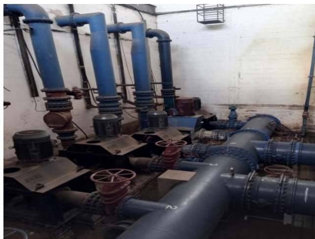
Figure 1 : Pompes de la SP1b installées en cale sèche
