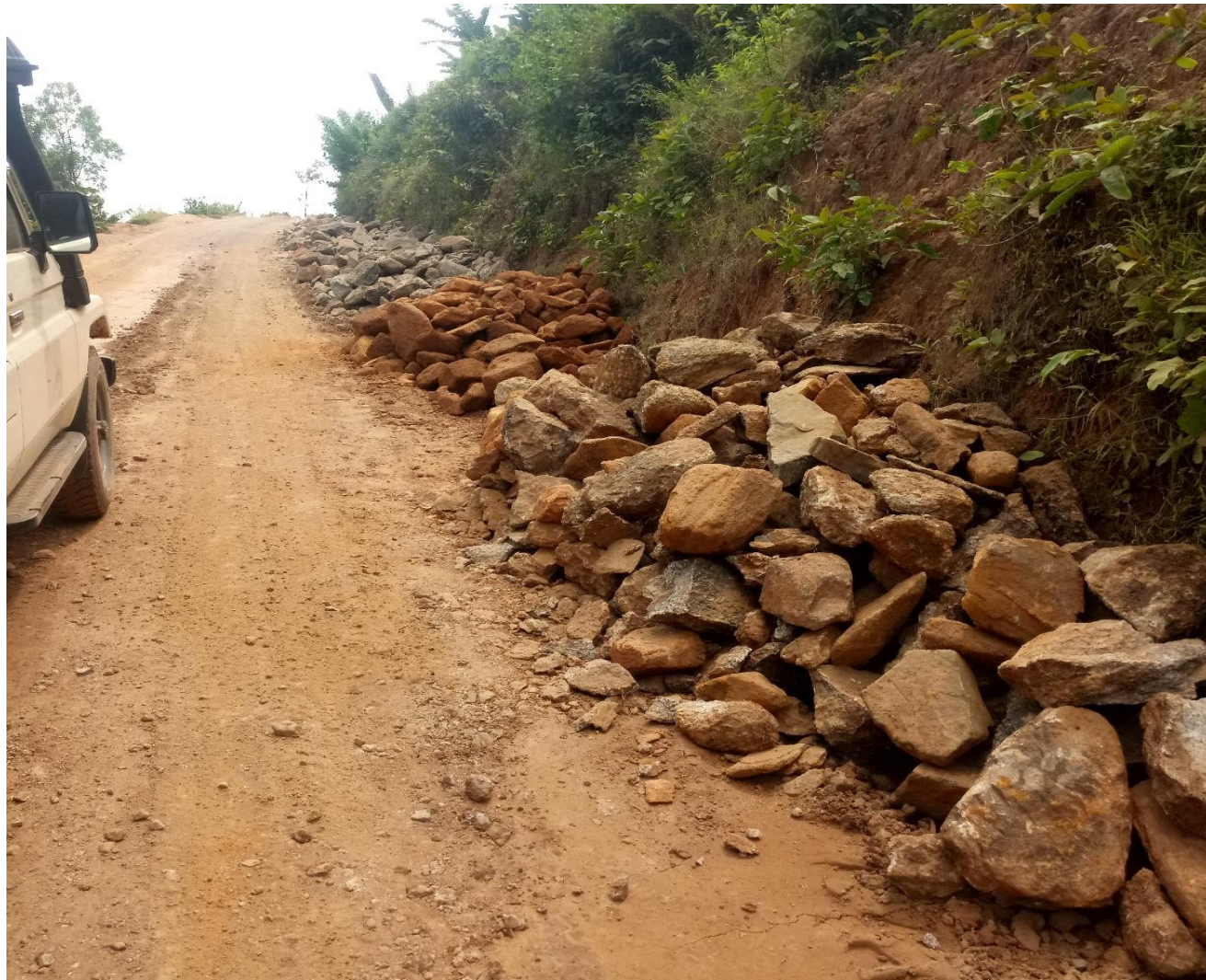
Photo 1:Route PMC avant réhabilitation
